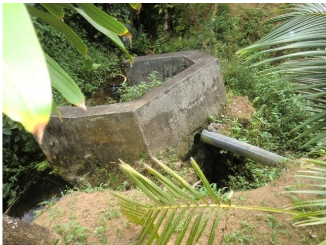
Figure 3.7 - Ouvrage du rejet effondré au niveau de la 1ere rivière
