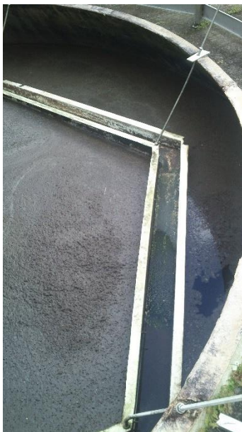
Figure 2.3 - Clarificateur & départs de boues
